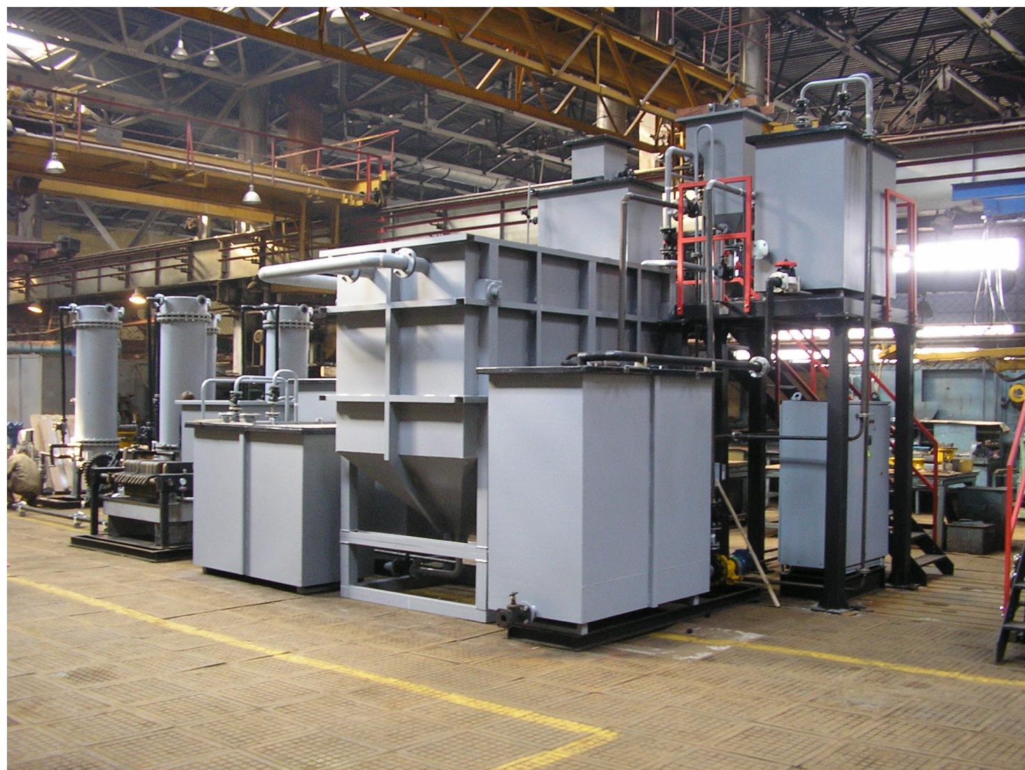
Комплекс очистных сооружений
